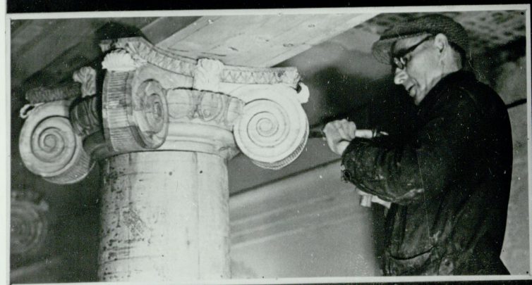
Sammaste viimistlus pärast montaaži /Foto R. Oalbre/ ОТДЕЛКА КОЛОНИАДЫ ПОСЛЕ МОНТАЖА /ФОТО Р. ОАЛБРЕ/
