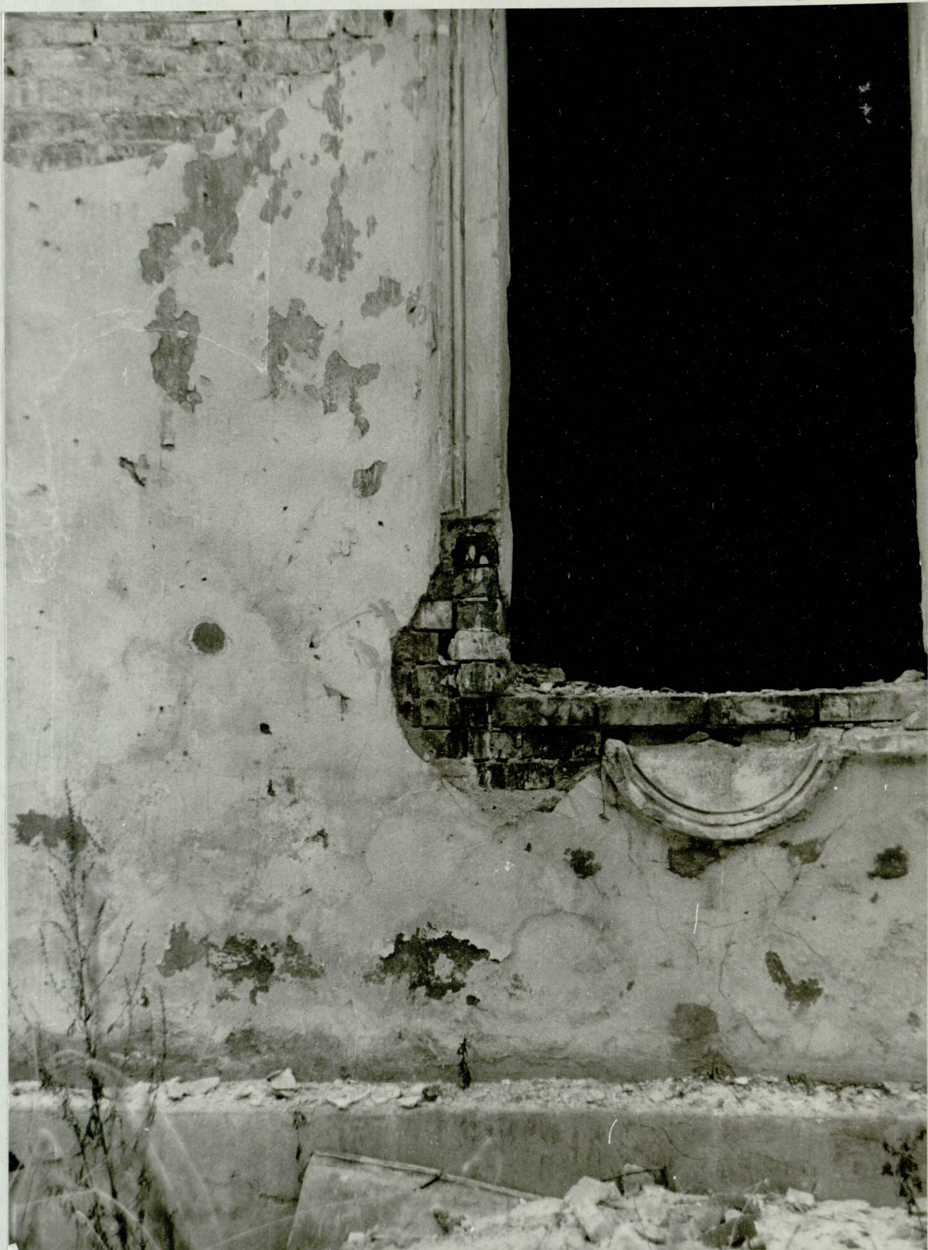
Рис.12 Разрушение кладки от плохого сцепления кирпича с раствором.
