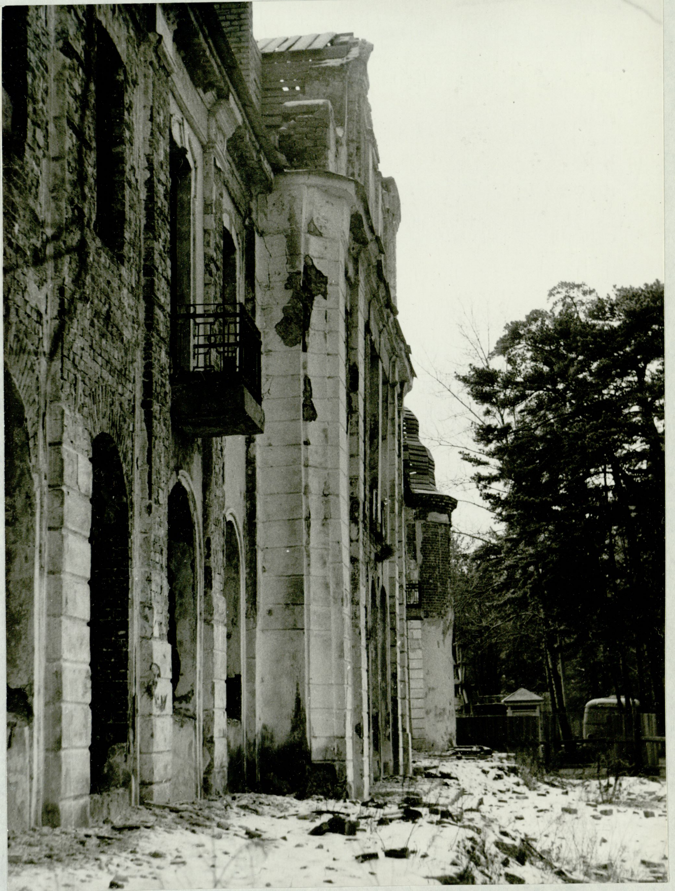
Рис.3 Наклон отколотой центральной части стены
