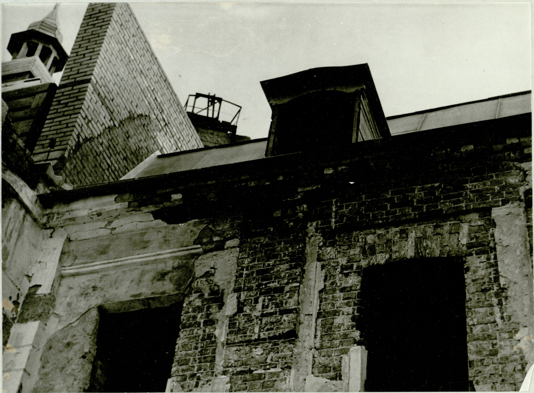
Рис. 6 Брандмауэр и размороженный карниз. Вид северного фасада.
