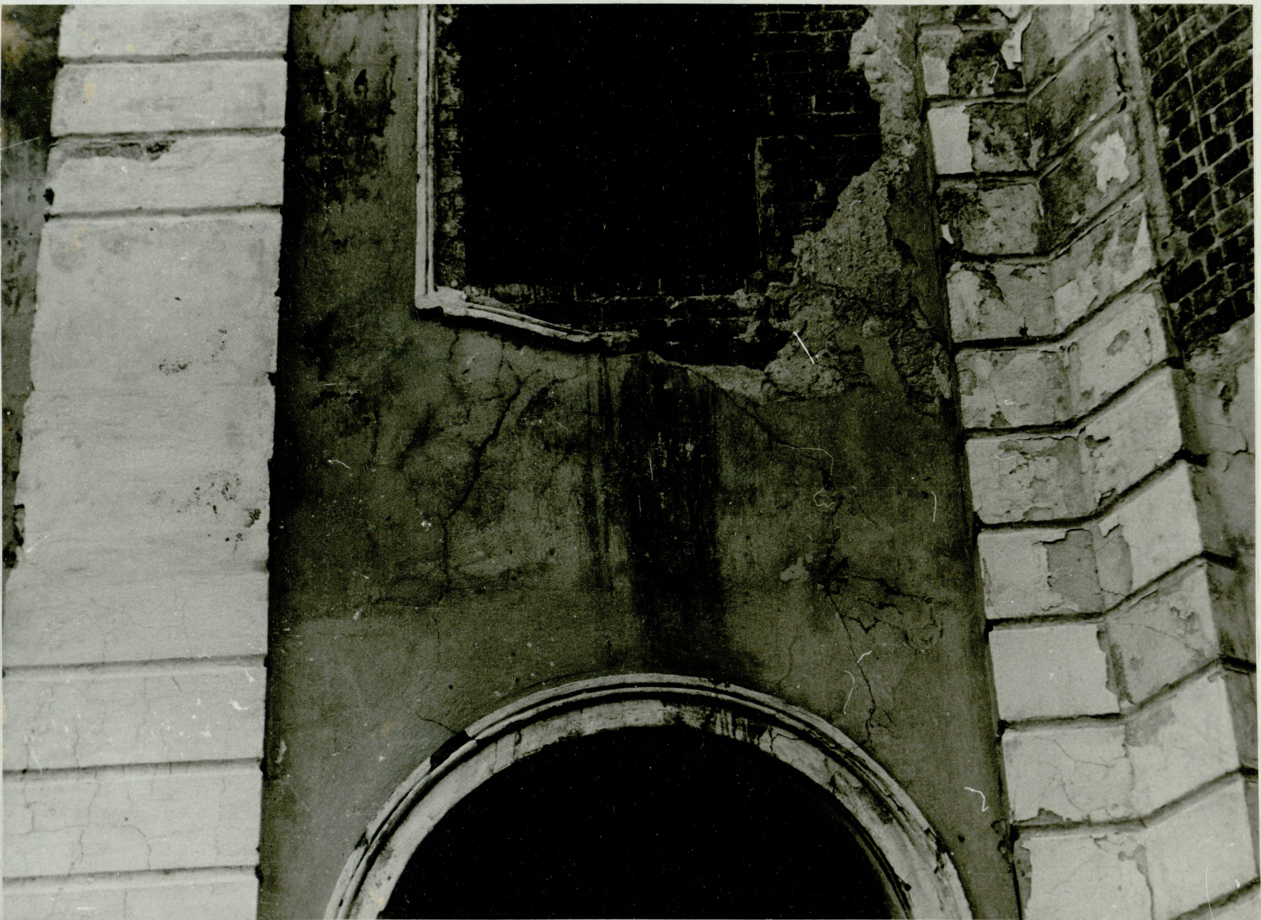
Рис. 7 Разрушение кладки северного фасада.
