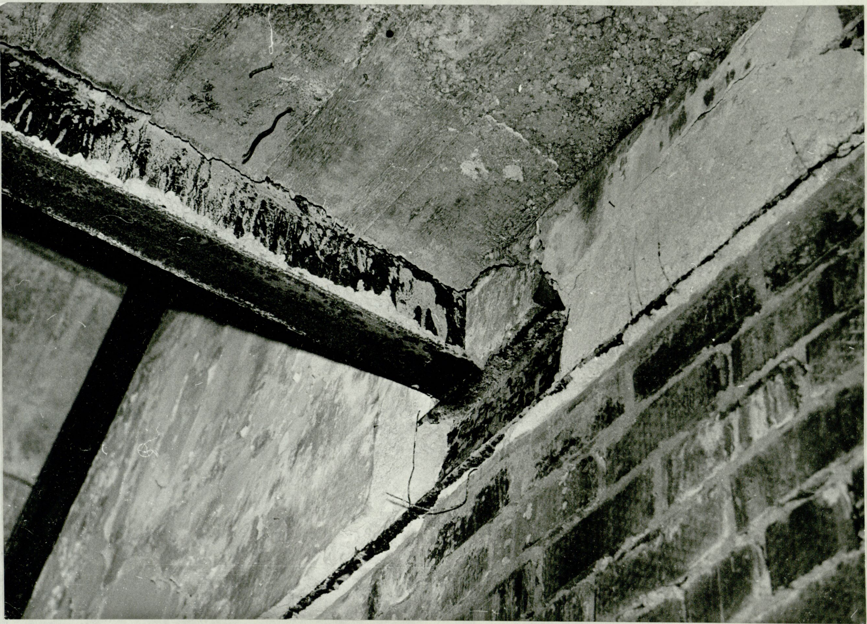
Рис. 43 Косоур на 3 этаже передает нагрузку на полку поперечного двутавра. Возможно разрушение шва, изгиб полки двутавра и вылом нижнего двутавра из стены.
