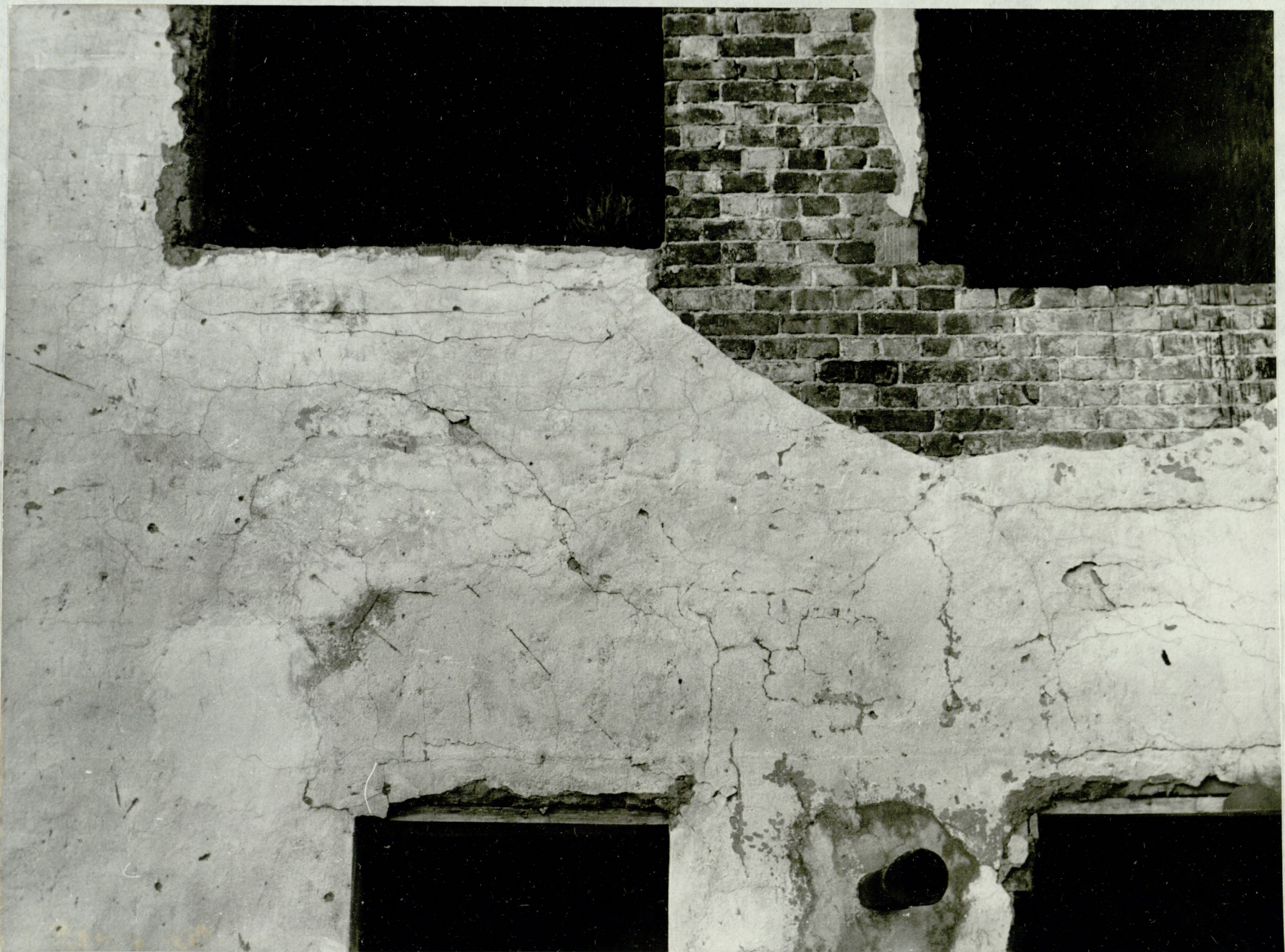
Рис. 22 Расстрескивание стен и расстрескивание штукатурки / Южный фасад / .
