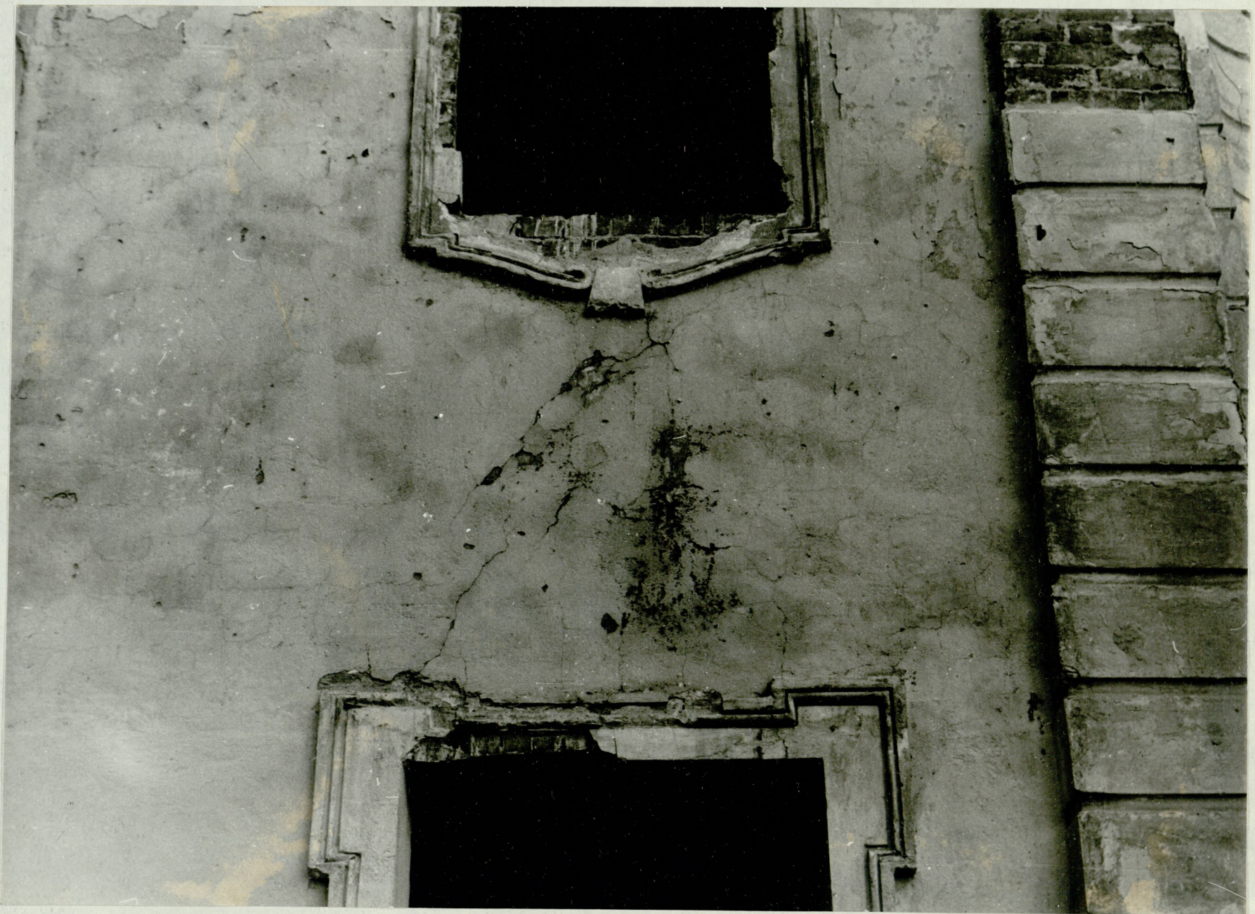
Рис.10 Разрушение кладки под штукатуркой. / Западный фасад/.
