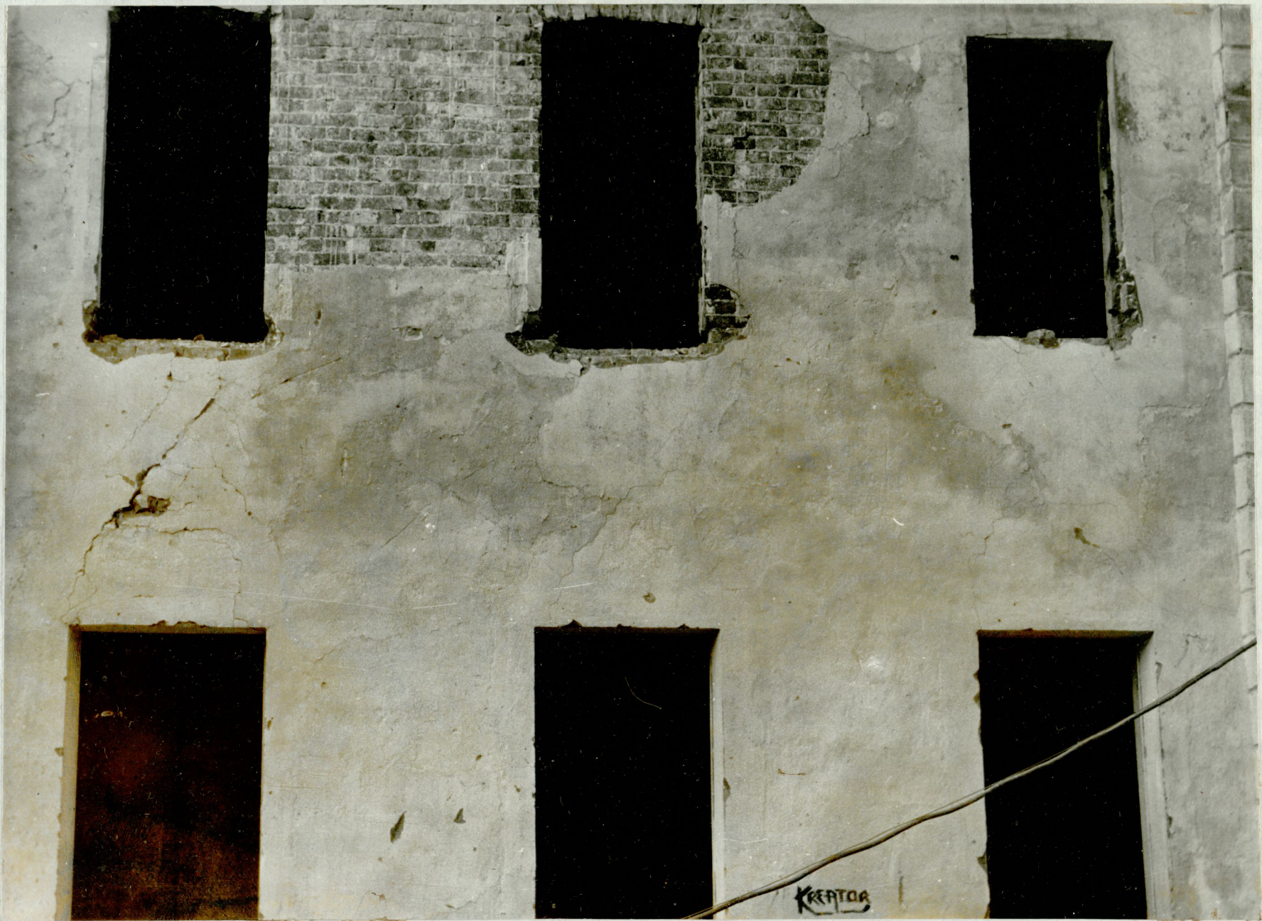
Рис.15 Разрушение левой части стены Южного фасада.
