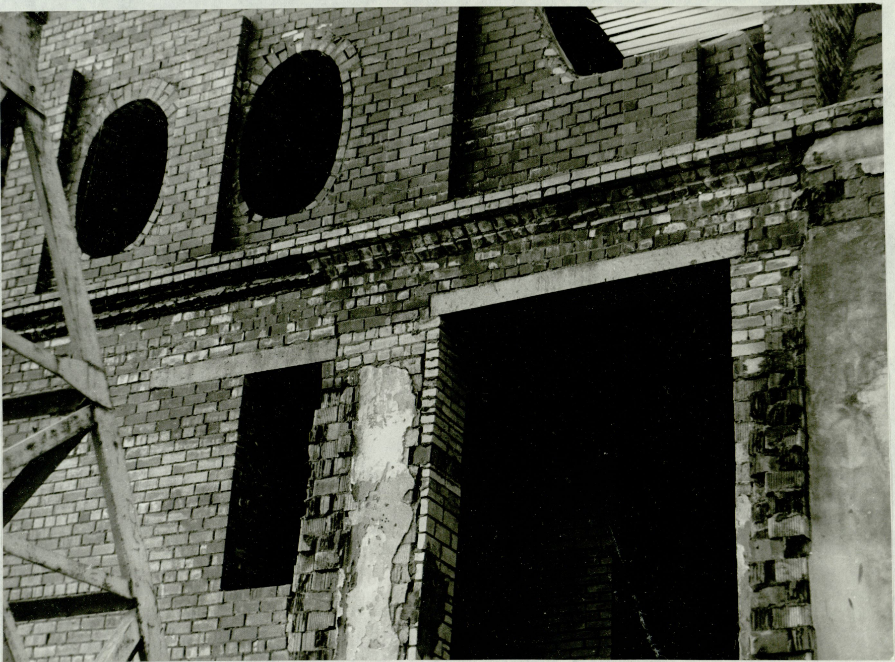
Рис. 19 Необходимость усиления опор перемычек. Возможен отвал приклада.
