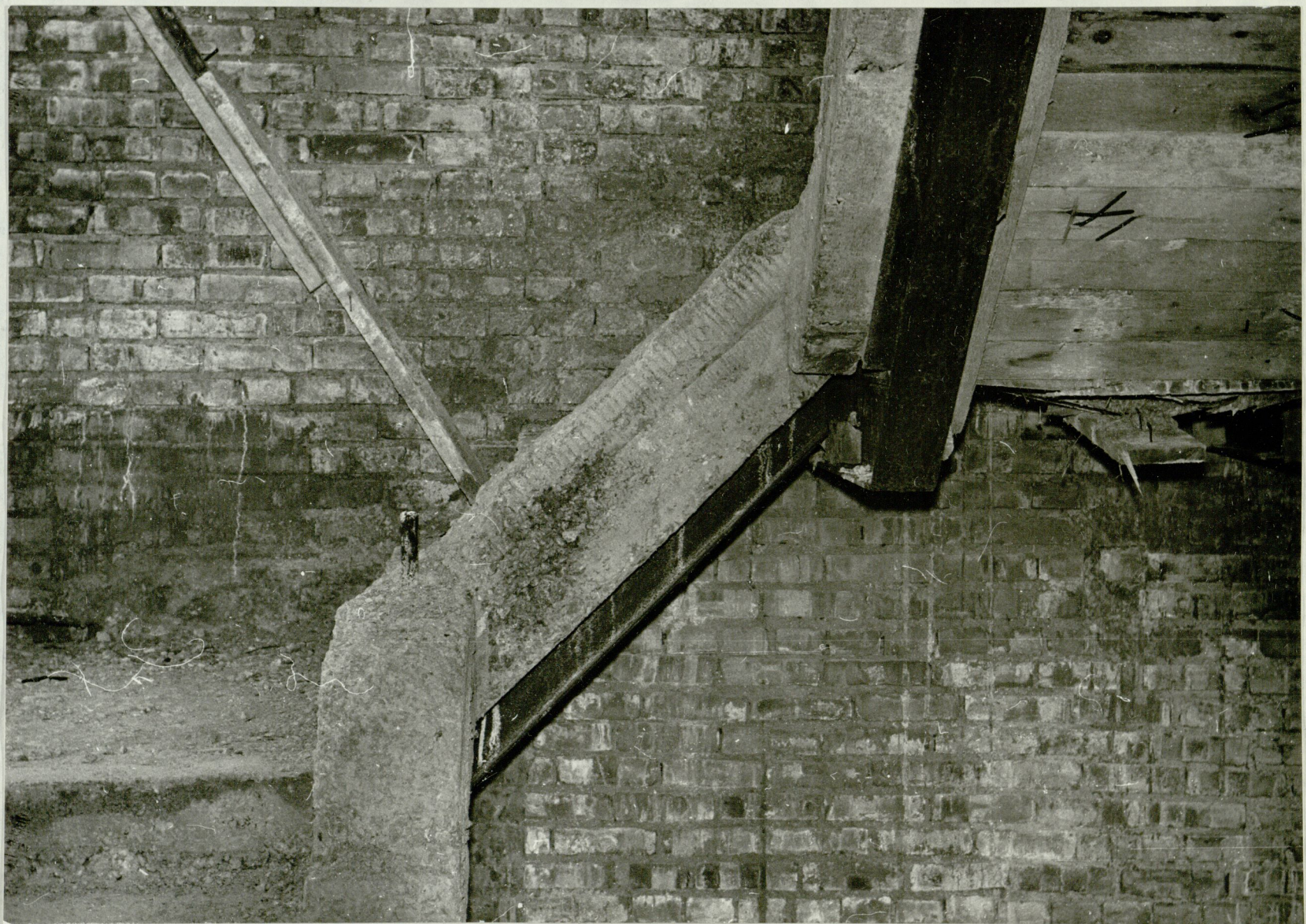
Рис.51 Ошибка в угле лестницы / уклон 1 : 1 /
