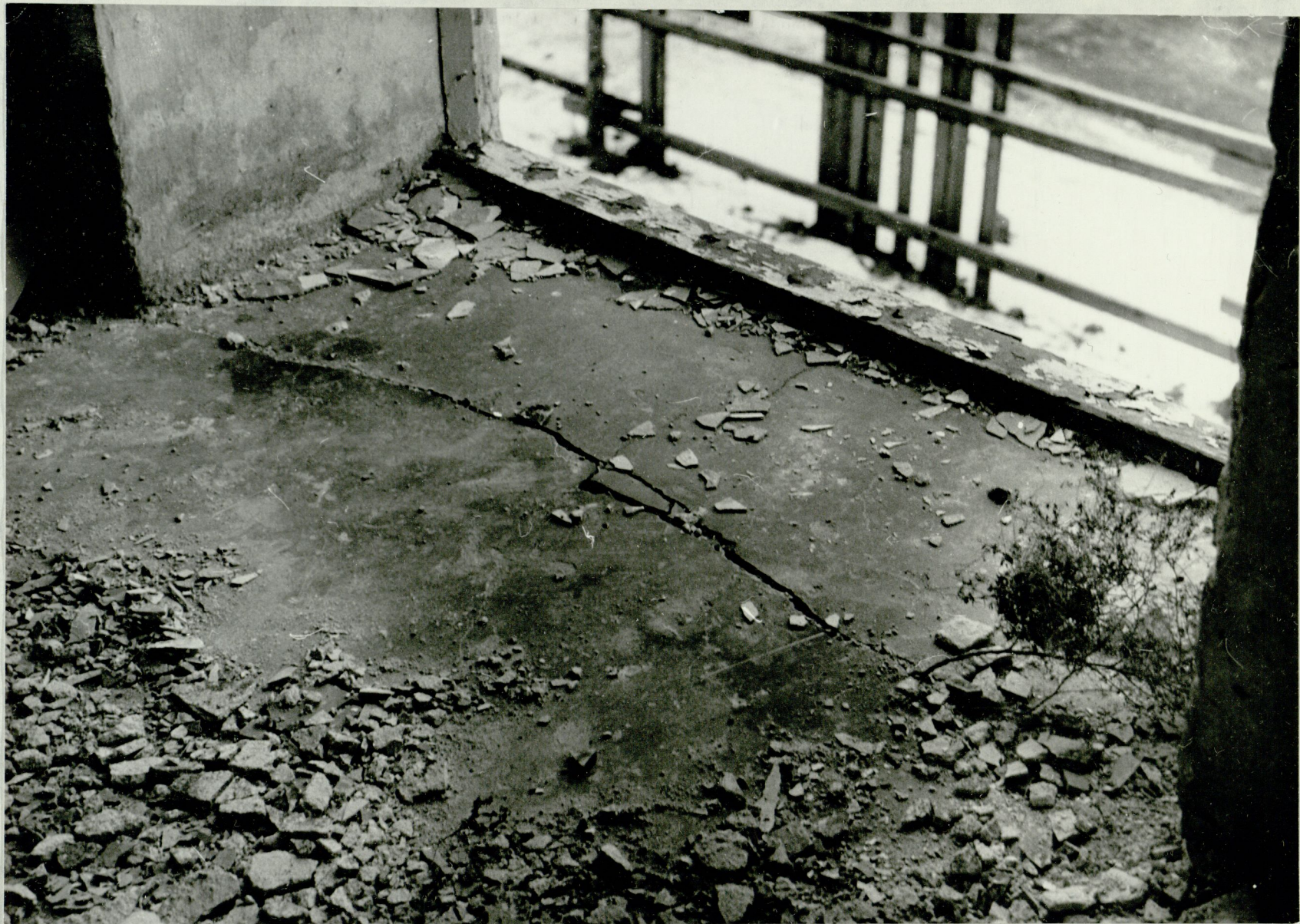
Рис. 42 Трещины откола стены северного фасада.
