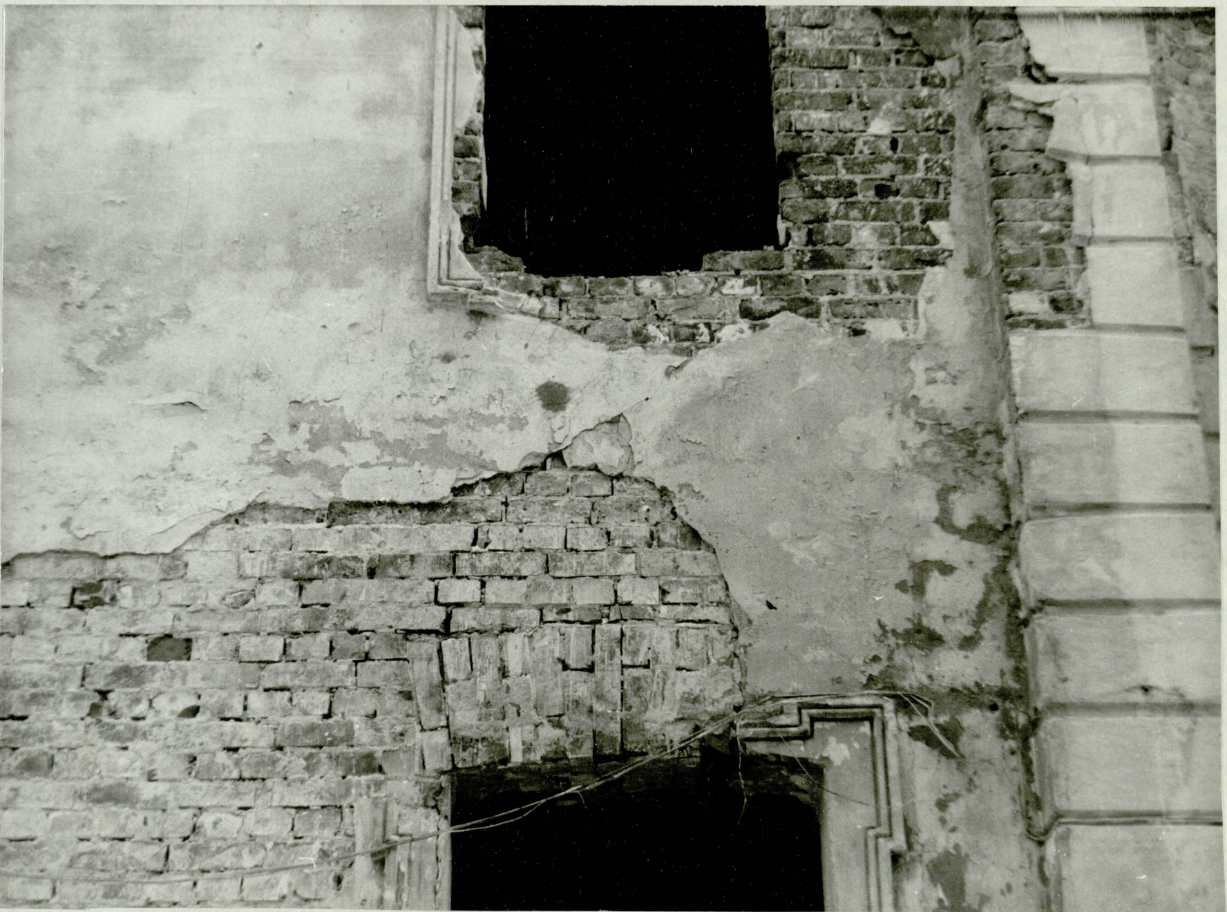
Рис.11 Разрушение горизонтальной перегородки. / Восточный фасад /.
