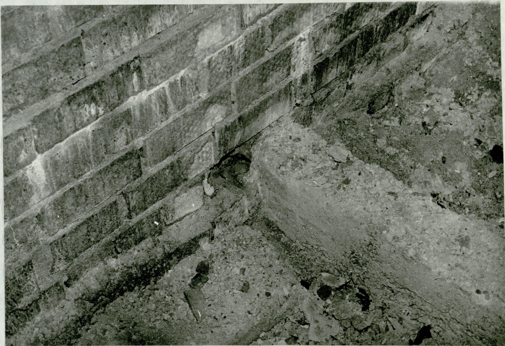
Рис. 26 Балка не опирается на стену.
