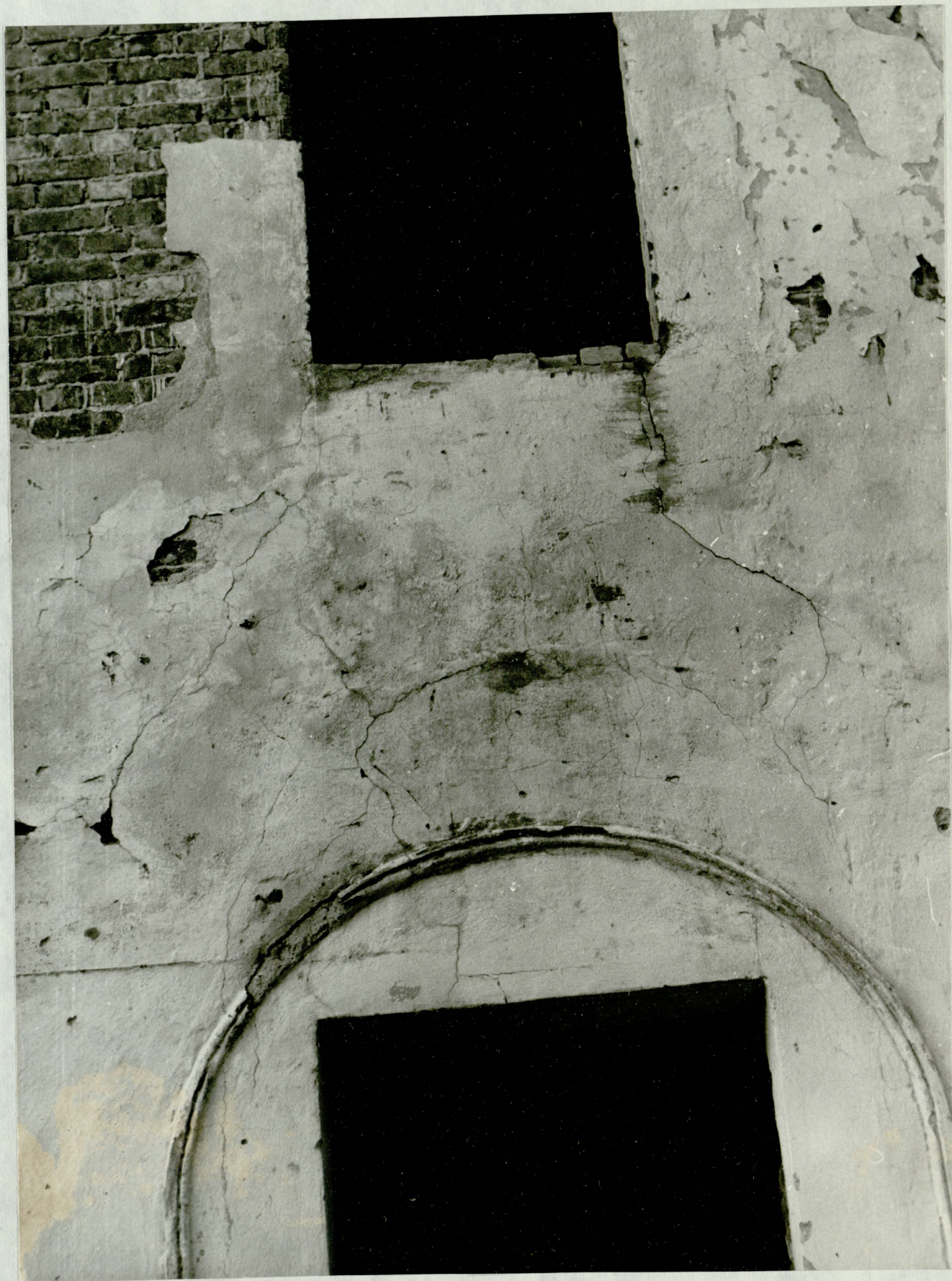
Рис.33 Разрушение горизонтальной перемычки над аркой / Южный фасад /.
