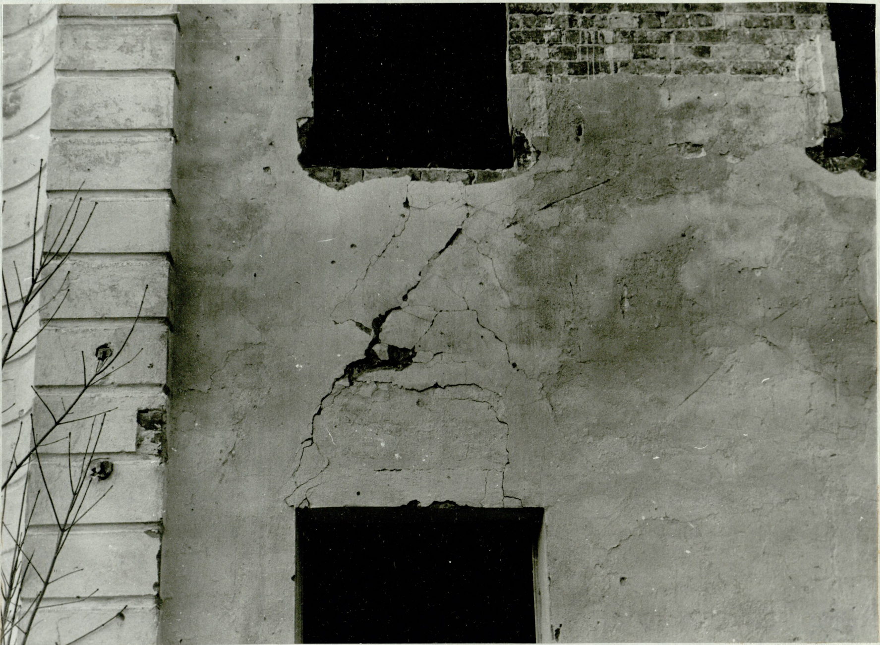
Рис. 16 Горизонтальная перемычка, где требуется усиление.
