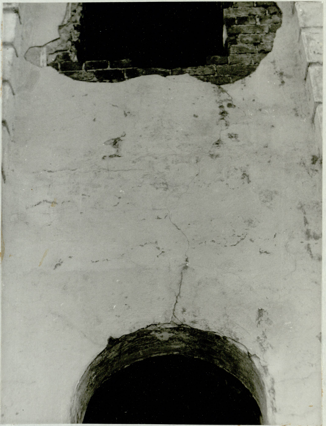
Рис.5 Повреждение штукатурки северного фасада / см.рис.2 /
