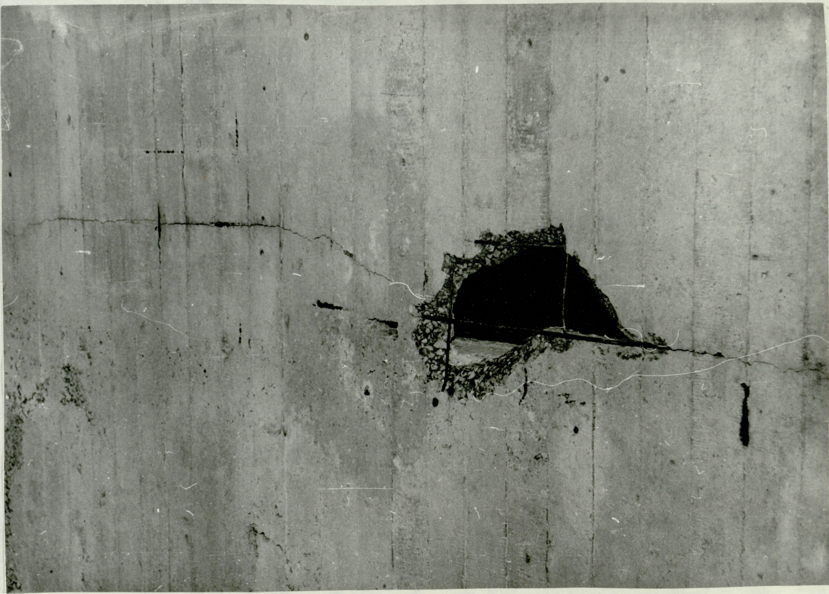
Рис.29 Трещина в плите и ее армирование. / Вид снизу /.
