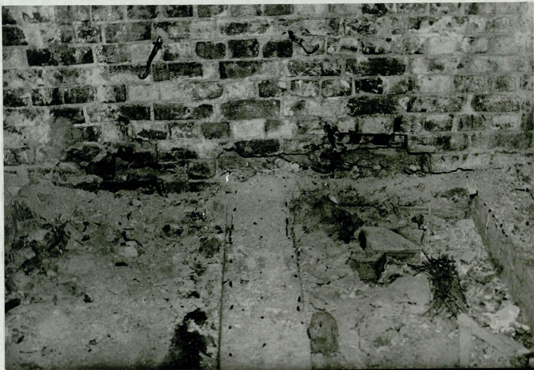
Рис. 25 Балки не заведены в стену.
