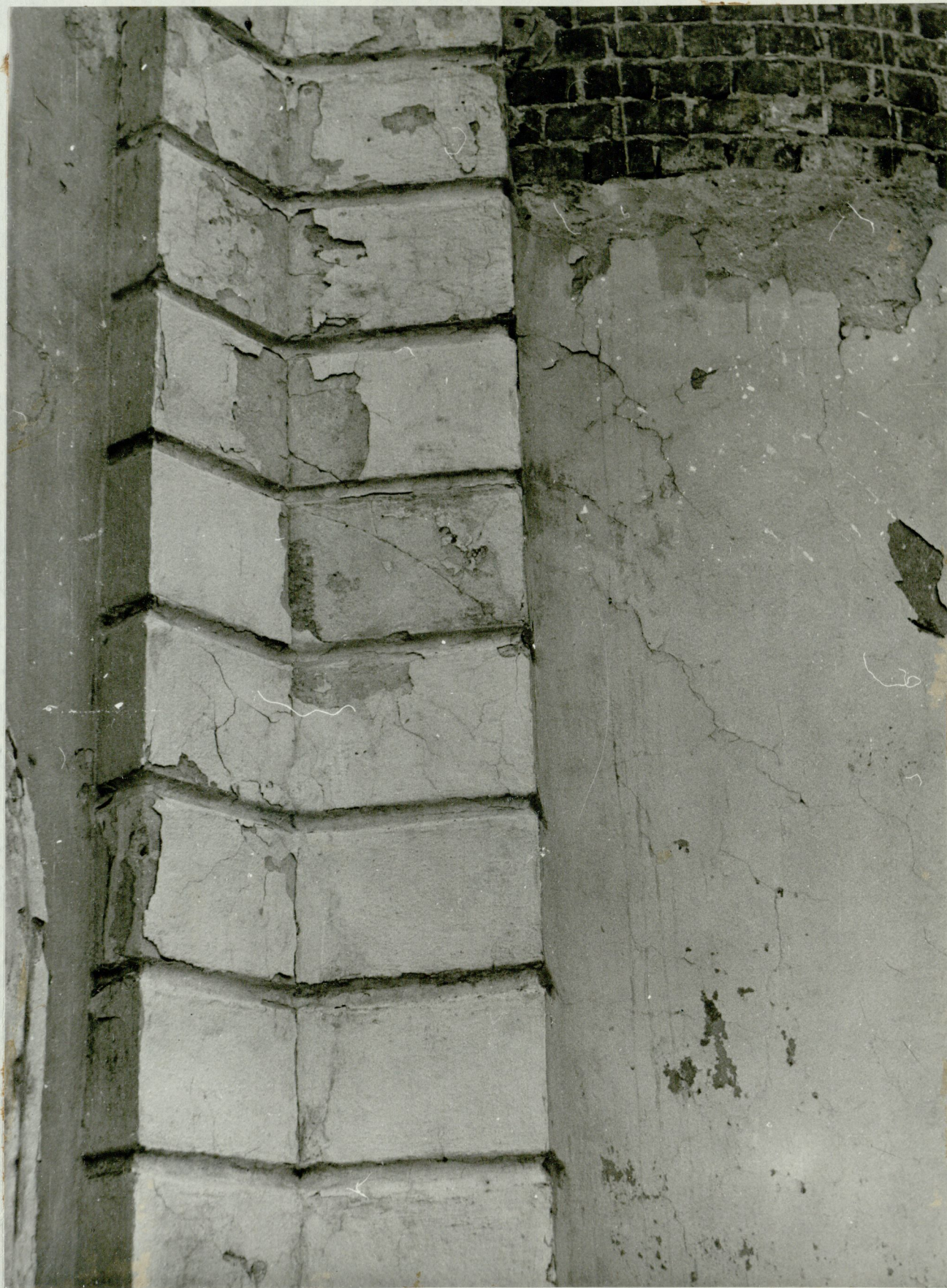
Рис.8 Повреждения штукатурного слоя. Возможны трещины в кладке.
